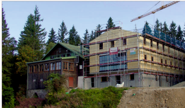
In Rekordzeit zum Richtfest: Der Rohbau für das neue Schutzhaus auf dem Falkenstein ist nur sieben Wochen nach dem Spatenstich fast fertig, das massive Sichtdach ist schon drauf.
