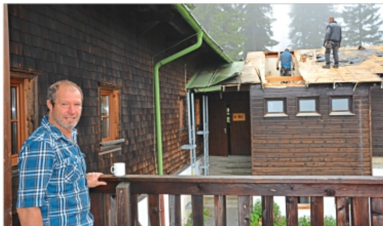
Hüttenwirt Michael Garhammer beobachtet die Arbeiten mit gemischten Gefühlen. Neben Wehmut überwiegt jedoch die Vorfreude auf das neue Schutzhaus.
