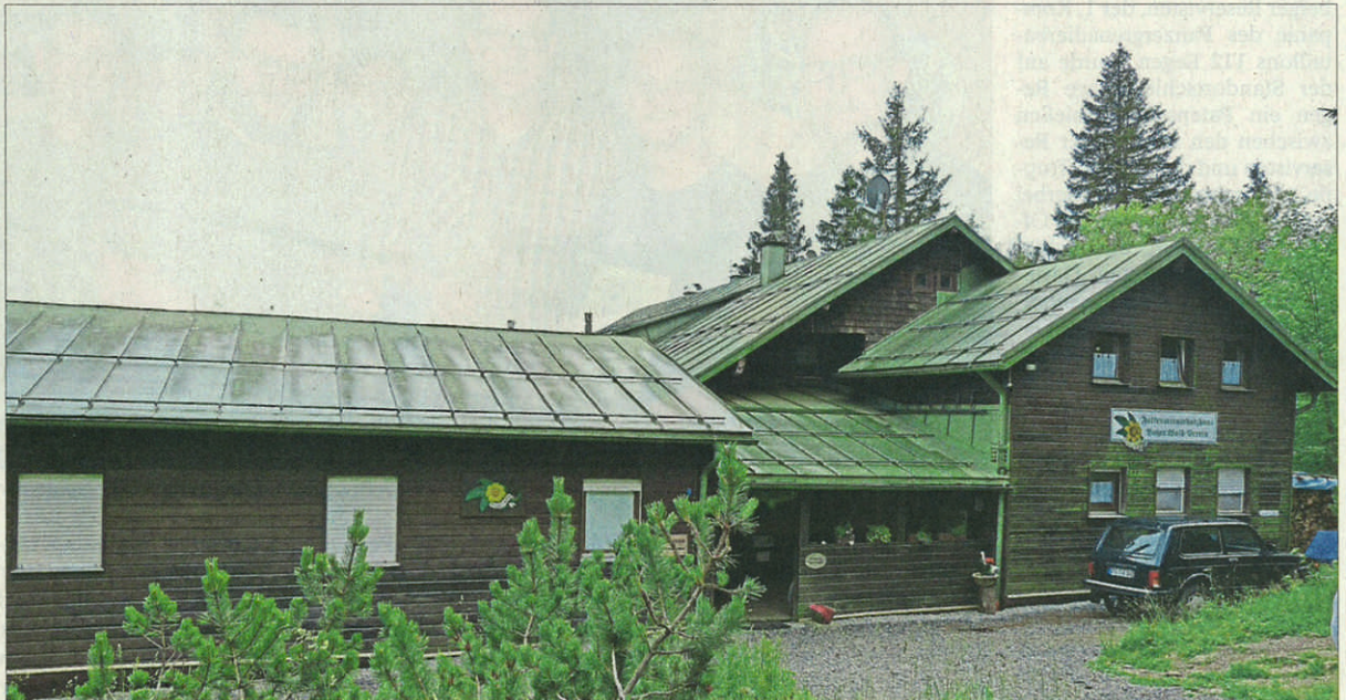
Das Falkenstein-Schutzhaus soll abgerissen und neu gebaut werden. Die Dachverschneidungen sind anfällig für Nässe, Schimmelbildung ist die Folge.
